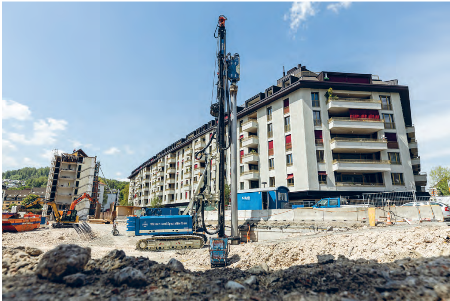
Baustelle der zweiten Etappe: Die alte Claridenstrasse wird rückgebaut, für die neue wird gefäht.
